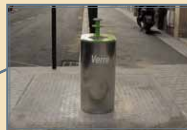
△ Présenté sous forme de cylindre en métal coiffé d'un couvercle vert, ce conteneur à verre enterré est installé rue Maître-Jacques.
